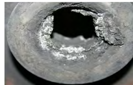
Rys. 8. Osadzanie się sadzy i innych materiałów z niewłaściwie przygotowanych wsadów na elementach pieca
