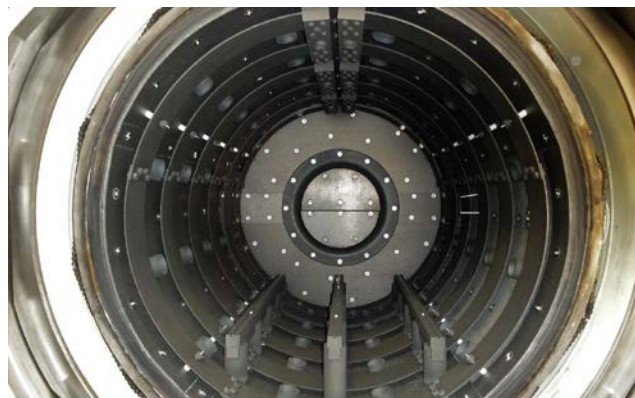
Rys. 13. Stan komory grzejnej właściwie eksploatowanego pieca próżniowego
