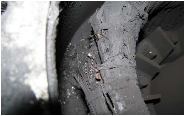
Rys. 8. Sadza zgromadzona wewnątrz silnika oraz widoczne przepalanie uzwojenia stojana
