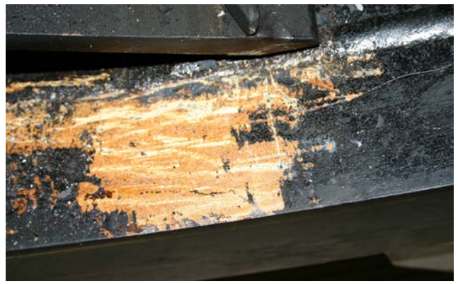
Rys. 9. Substancja smolista na obudowie wewnętrznej pieca powstała ze zmieszania się sadzy oraz olejów z niewłaściwie umytych wsadów
